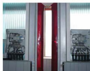
Блок управления электроприводов
